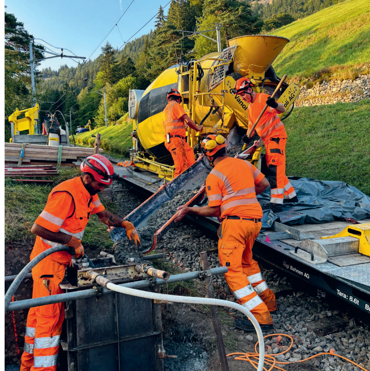
Zusammenarbeit mit der Firma C. Vanoli beim Fundamentbau der neuen Fahrleitung Freibergen-Kaltbad.
